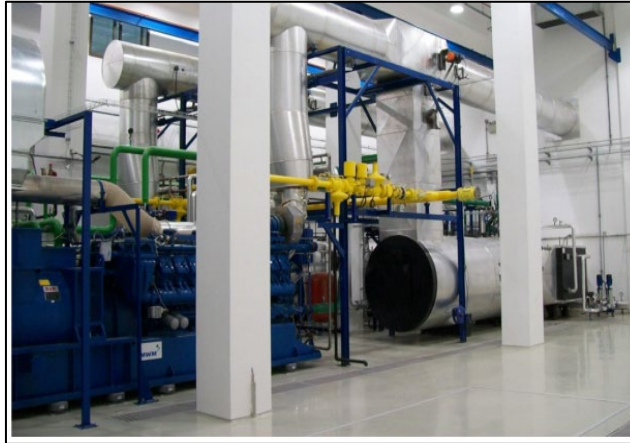
Şekil 2. Trijenerasyon Güç Tesisi
